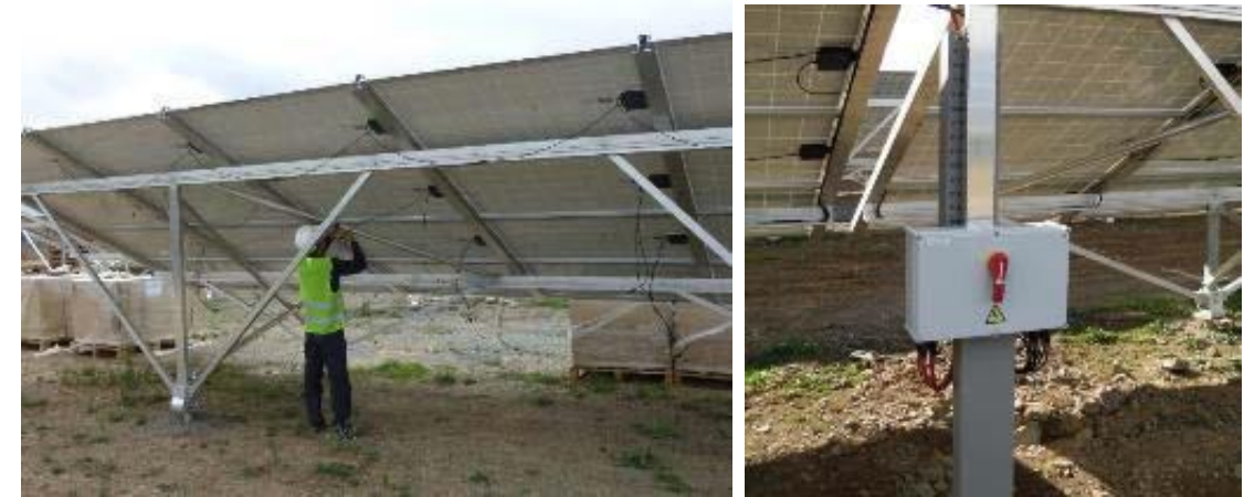
Photo 36. A gauche : câblage des panneaux – A droite : boîtier de raccordement
